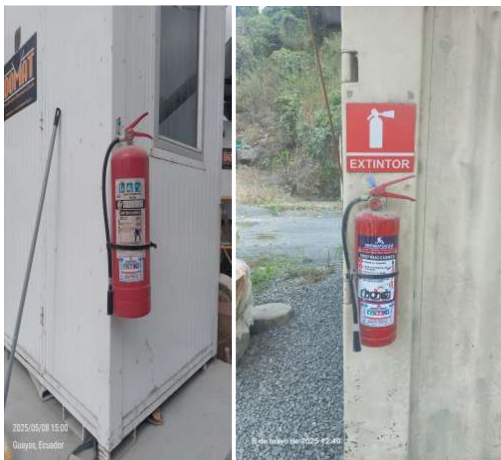
Foto 12. Extintores en las instalaciones de cuarto de generadores, y planta de hormigón
