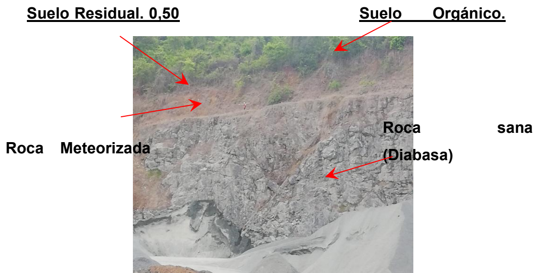
Figura 5.1-10. Perfil de meteorización en el frente de explotación.
