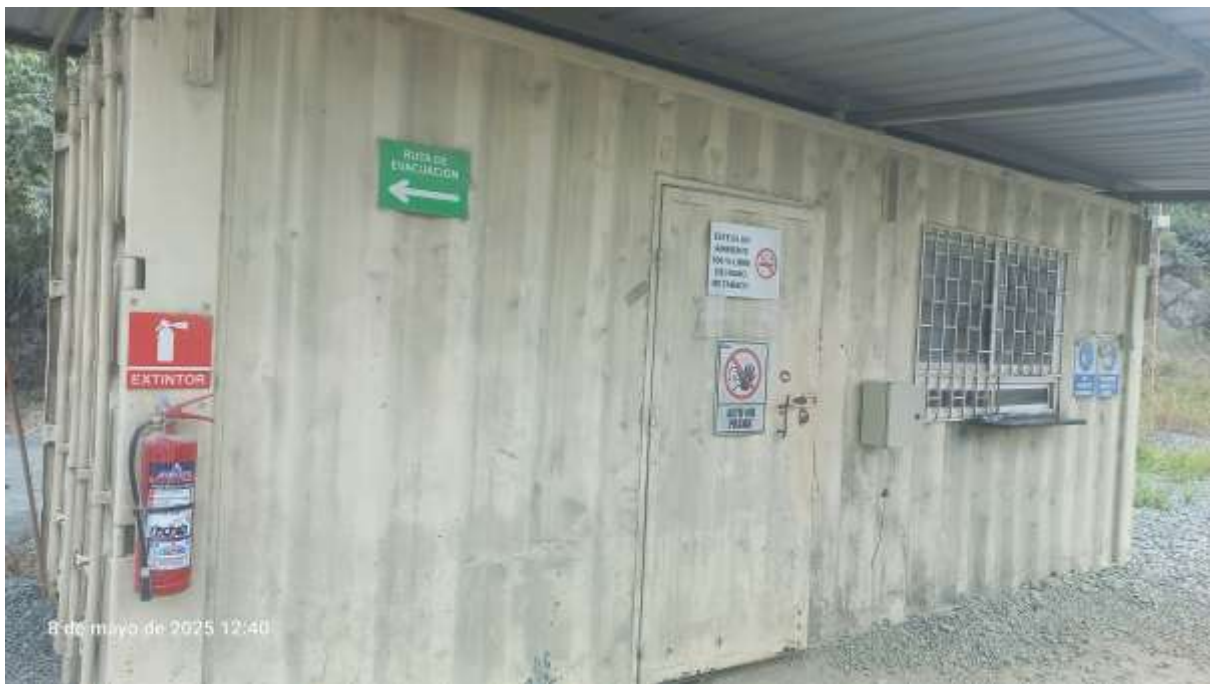
Foto 15. Extintores y señalética en el cuarto de extintores y cartel de ruta de evacuación.
