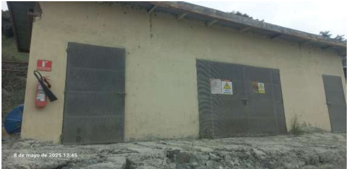
Foto 14. Extintores y señalética en el cuarto de generadores.
