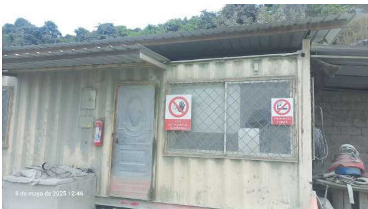
Foto 13. Extintores y señalética en el cuarto de generadores.
