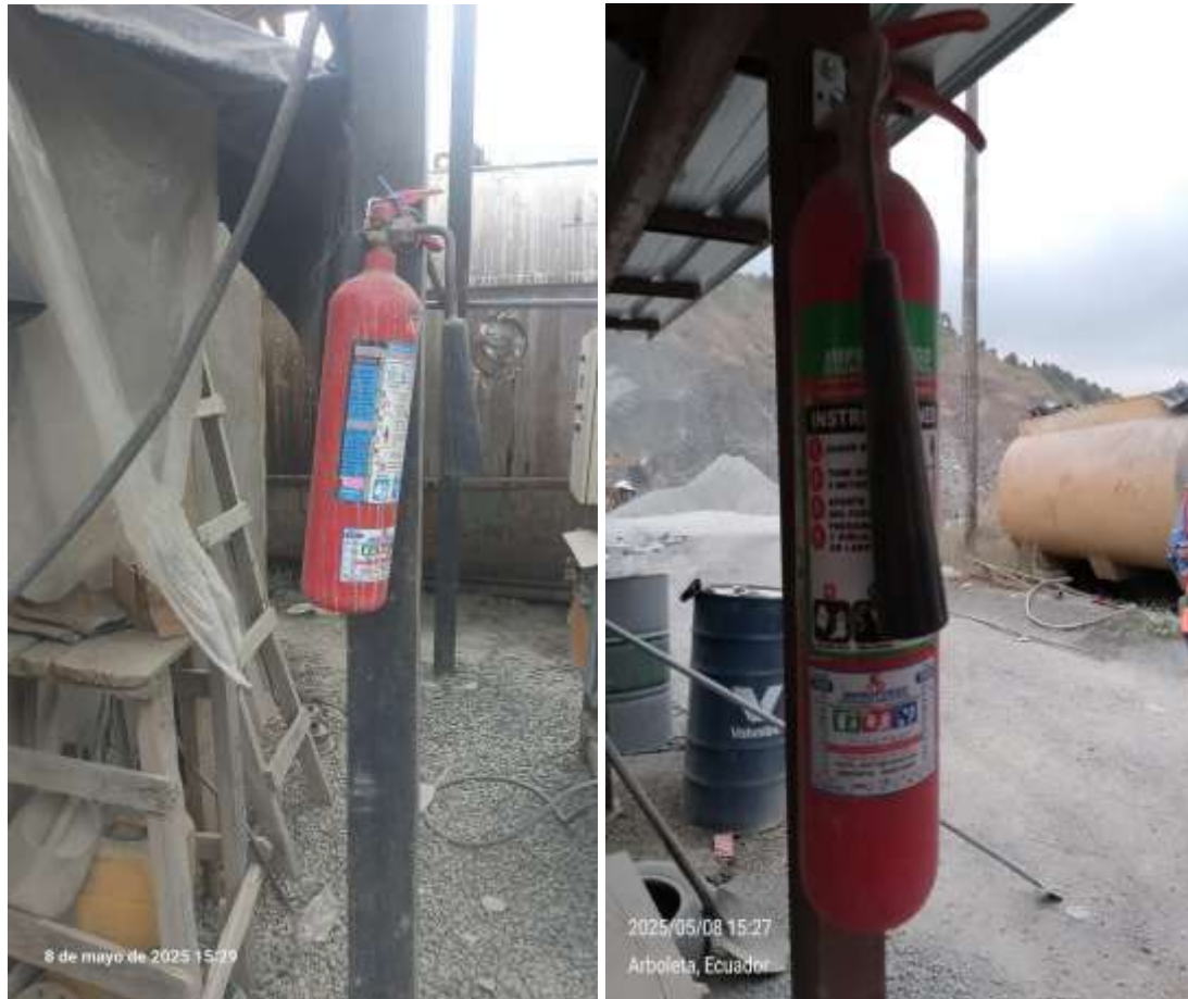
Foto 11. Extintores en las instalaciones de planta de asfalto
