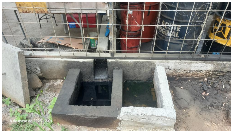
Figura 2.6-7. Trampa De Grasa Área De Almacenamiento De Desechos Peligrosos
