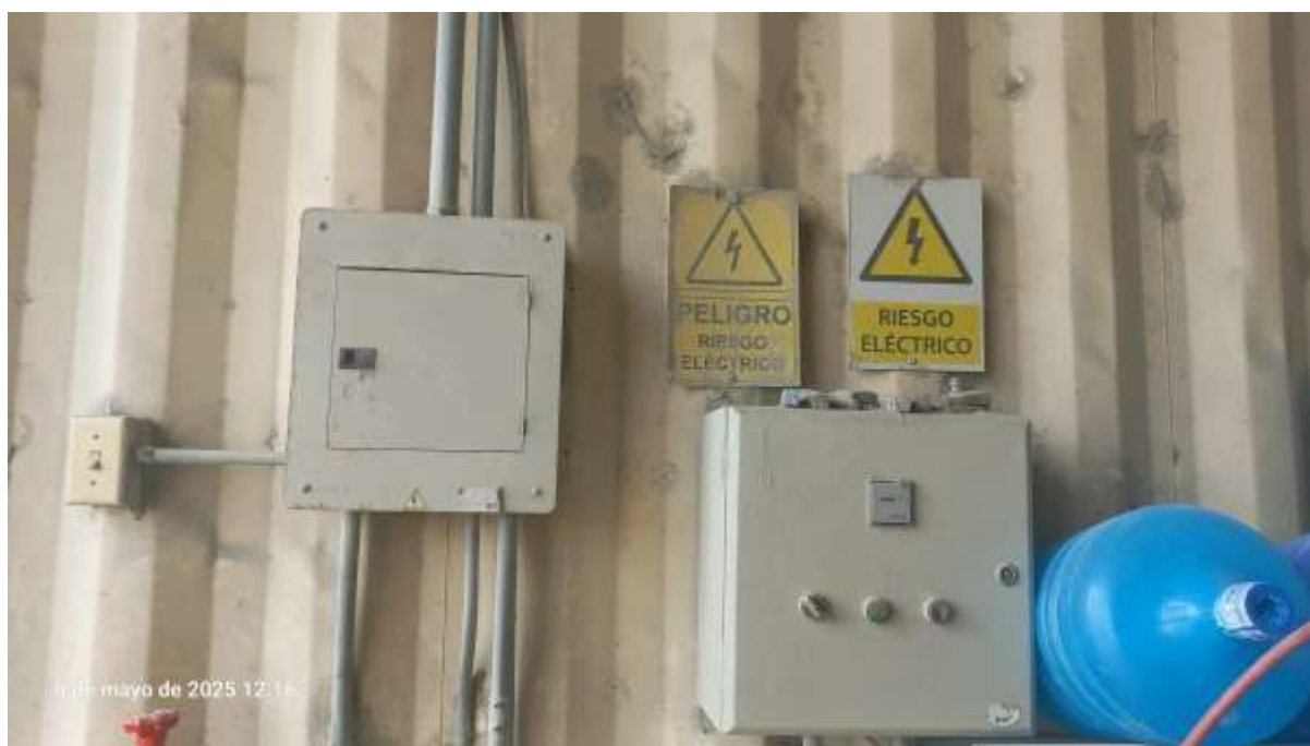
Foto 3. Señaletica en el área de soldadura.
