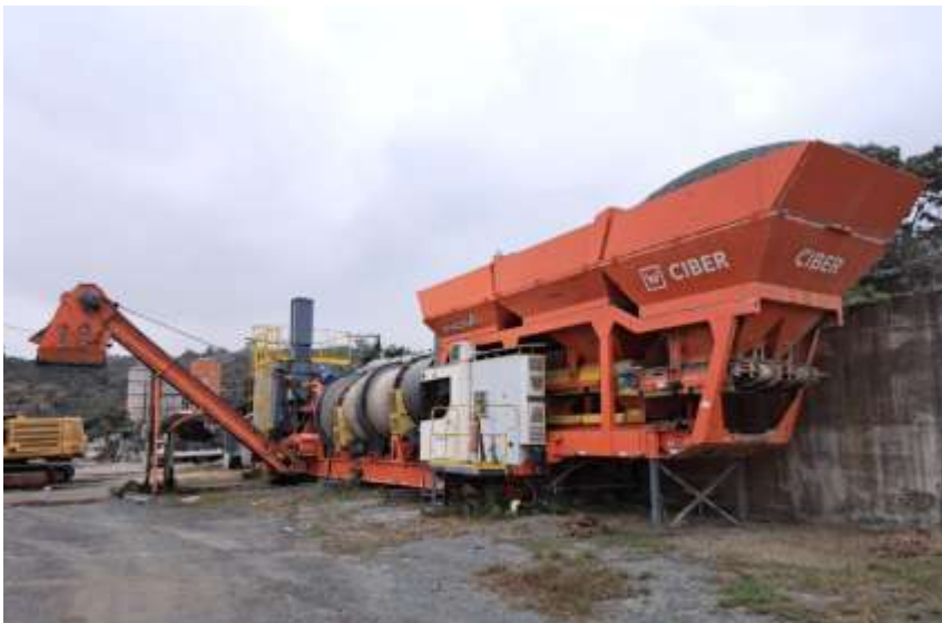
Foto 39. Planta de Asfalto
