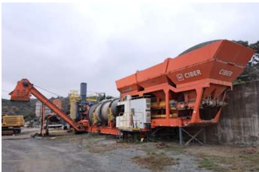
Foto 39. Planta de Asfalto
