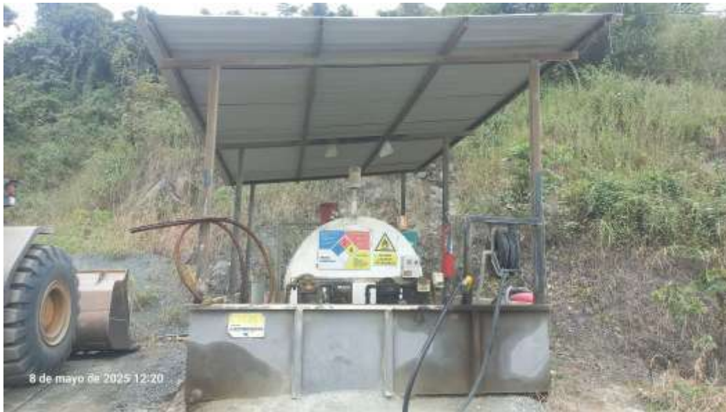
Foto 16. Tanque de Diesel
