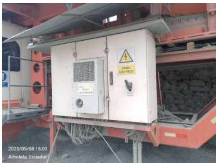
Foto 31. Panel Eléctrico Planta de Asfalto.
